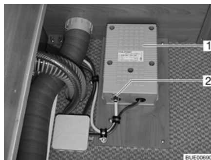
Fig. 166 Transformateur du chauffage électrique du plancher
