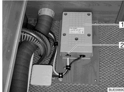
Kuva 226 Sähköisen lattialämmityksen muuntaja
