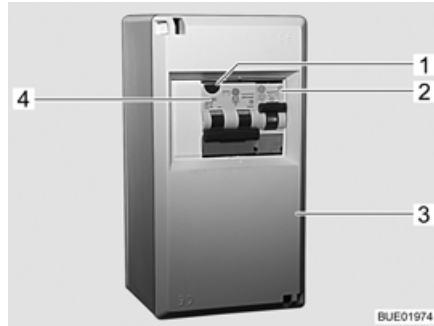
Afb. 141 230-V-zekeringenkast met beveiligingsautomaat en FI-schakelaar
