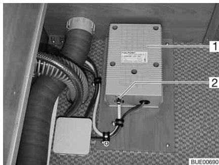
Billede 205 Transformator for elektrisk gulvopvarmning
