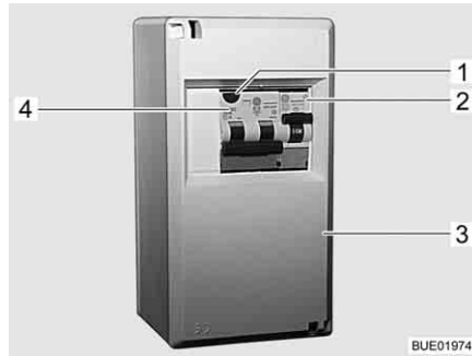
Kuva 120 230 V:n sulakerasia ja johdinsuojakytkin sekä FI-kytkin
