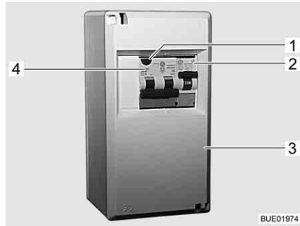
Fig. 167 Coffret de fusibles 230 V avec disjoncteur de protection de circuit et disjoncteur FI
