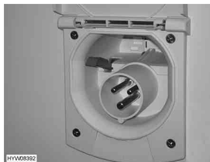
Afb. 168 230-V-aansluiting op het voertuig
