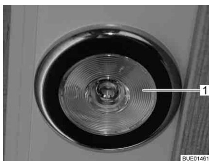
Bild 96 Infälld lampa, ljusbrytare i lampan
