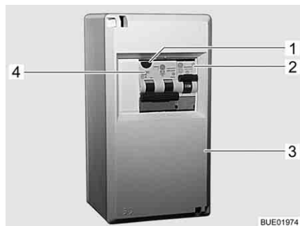
Bild 167 230 V-säkringslåda med ledningsskyddsbrytare och FI-brytare
