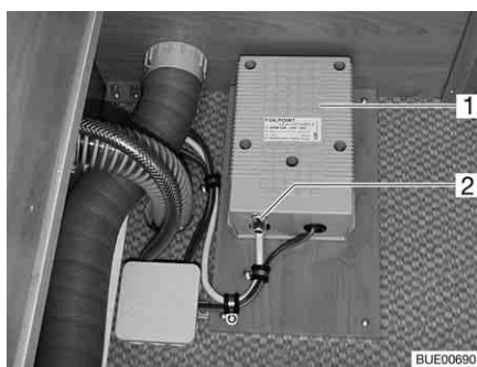
Bild 202 Transformator för elektrisk golvvärme
