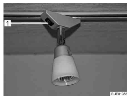
Fig. 62 Faretto alogeno, interruttori luci in corrispondenza della lampada
