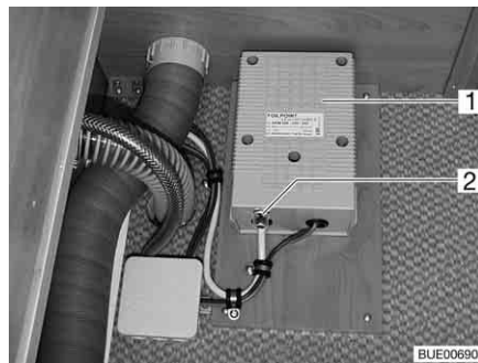
Fig. 176 Trasformatore per riscaldamento elettrico del pavimento
