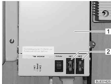
Bild 147 Regler Heizung für Abwasserleitungen
