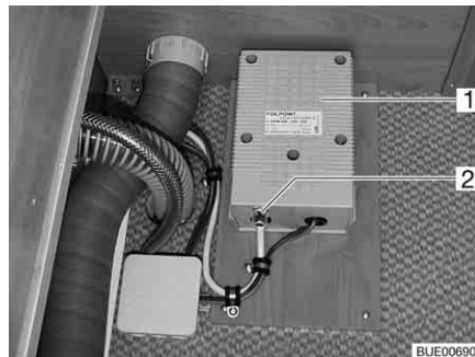
Bild 176 Trafo für elektrische Fußbodenerwärmung
