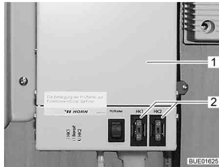
Fig. 147 Regulador de la calefacción para las tuberías de aguas residuales
