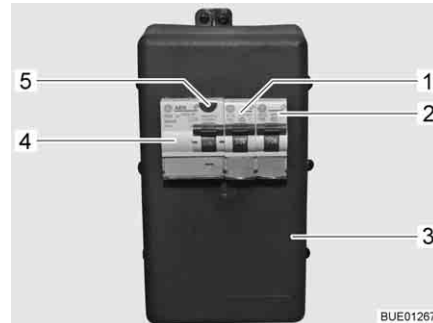
Fig. 151 Caja de fusibles de 230 V con interruptor de protección de línea e interruptor FI
