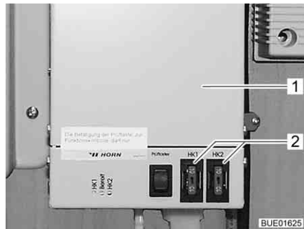
Fig. 106 Regolatore riscaldamento per tubazioni delle acque grigie
