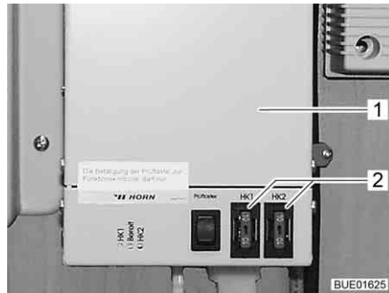
Bild 106 Regler Heizung für Abwasserleitungen
