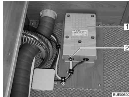
Bild 121 Trafo für elektrische Fußbodenerwärmung
