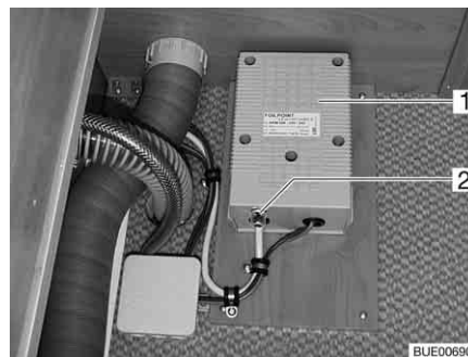
Kuva 176 Sähköisen lattialämmityksen muuntaja
