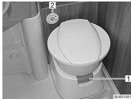
Kuva 261 WC-istuin ja valvonta- ja säätöyksikkö
