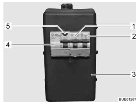
Fig. 163 Caja de fusibles de 230 V con interruptor de protección de línea e interruptor FI
