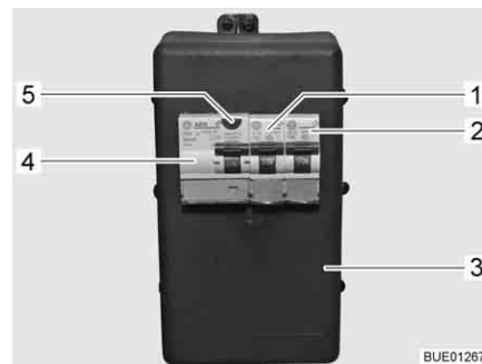
Fig. 175 Caja de fusibles de 230 V con interruptor de protección de línea e interruptor FI
