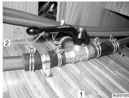
Fig. 197 Válvula de 3 vías
