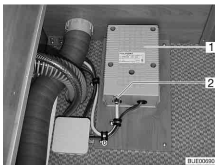
Fig. 202 Trasformatore per riscaldamento elettrico del pavimento
