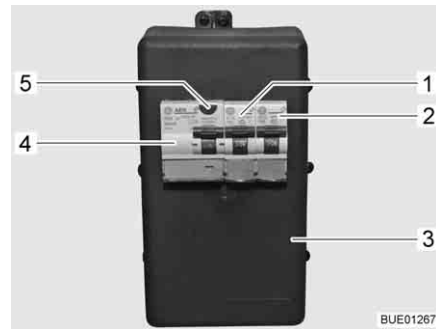
Fig. 163 Scatola dei fusibili a 230 V con interruttore di sicurezza e interruttore automatico FI
