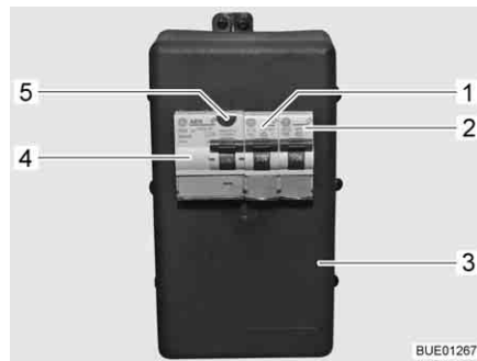
Fig. 163 Coffret de fusibles 230 V avec disjoncteur de protection de circuit et disjoncteur FI
