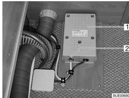
Billede 193 Transformator for elektrisk gulvopvarmning
