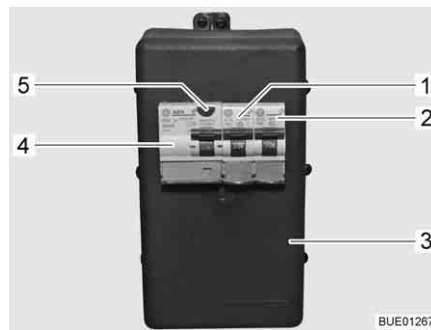
Billede 156 230 V-sikringsskab med sikkerhedsafbryder og HFI-afbrydere
