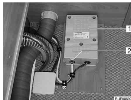
Bild 193 Transformator för elektrisk golvvärme
