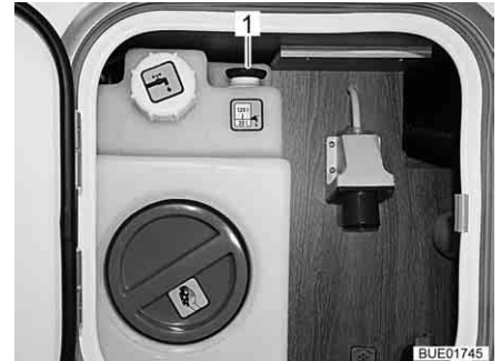
Bild 232 Vattentank (central försörjningsenhet)
