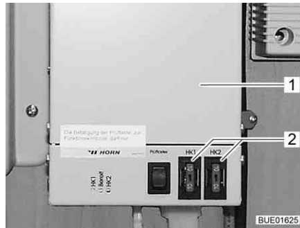
Fig. 164 Régulateur du chauffage des conduites des eaux usées
