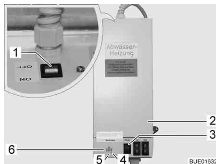
Bild 209 Trafo mit Regelgerät
