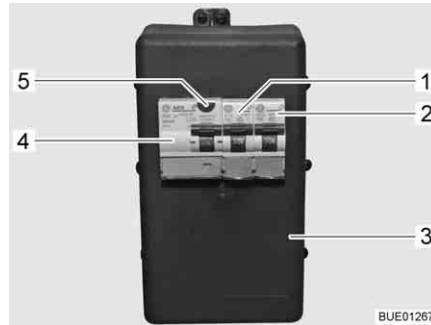
Bild 153 230-V-Sicherungskasten mit Leitungsschutzschalter und FI-Schalter
