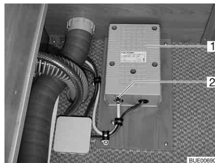
Bild 174 Trafo für elektrische Fußbodenerwärmung
