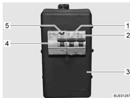
Billede 160 230 V-sikringskab med sikkerhedsafbryder og HFI-afbrydere
