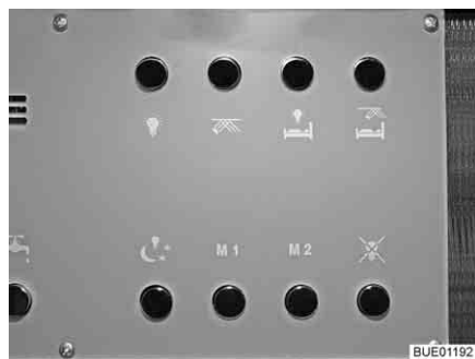
Fig. 84 Pannello di controllo
