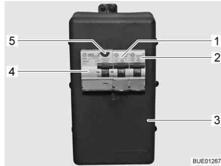
Fig. 160 Scatola dei fusibili a 230 V con interruttore di sicurezza e interruttore automatico FI
