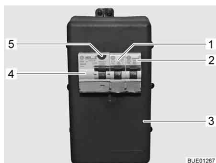
Fig. 109 Coffret de fusibles 230 V avec disjoncteur de protection de circuit et disjoncteur FI
