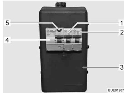
Bild 173 230-V-Sicherungskasten mit Leitungsschutzschalter und FI-Schalter
