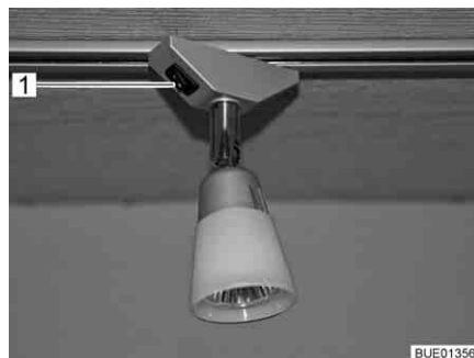
Bild 62 Spotleuchte, Lichtschalter direkt an der Leuchte (Beispiel)
