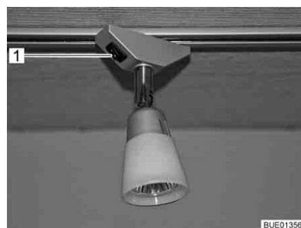
Bild 61 Halogenspotleuchte, Lichtschalter direkt an der Leuchte
