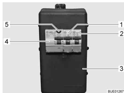
Kuva 139 230 V:n sulakerasia ja johdinsuojajakytkin sekä FI-kytkin
