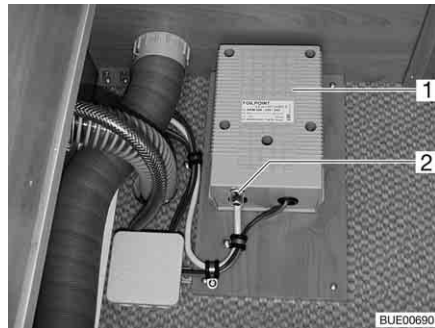
Fig. 169 Transformador para calentamiento eléctrico del piso
