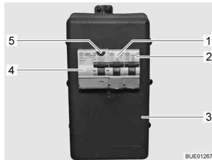
Bild 96 230-V-Sicherungskasten mit Leitungsschutzschalter und FI-Schalter
