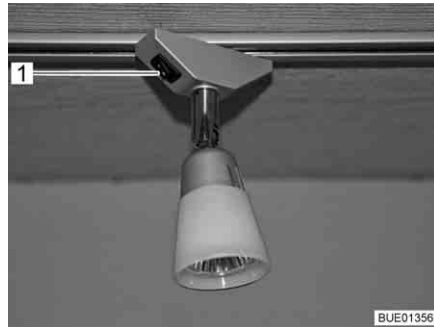
Bild 41 Spotleuchte, Lichtschalter direkt an der Leuchte
