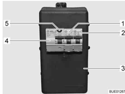
Bild 176 230-V-Sicherungskasten mit Leitungsschutzschalter und FI-Schalter
