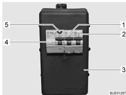
Fig. 178 Coffret de fusibles 230 V avec disjoncteur de protection de circuit et disjoncteur FI
