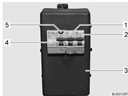
Fig. 189 Coffret de fusibles 230 V avec disjoncteur de protection de circuit et disjoncteur FI
