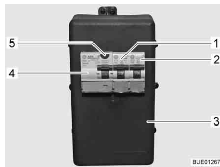
Afb. 189 230-V-zekeringenkast met beveiligingsautomaat en FI-schakelaar
