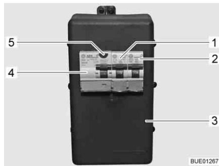
Bild 178 230-V-Sicherungskasten mit Leitungsschutzschalter und FI-Schalter
