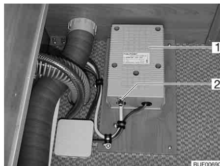
Bild 211 Trafo für elektrische Fußbodenerwärmung
