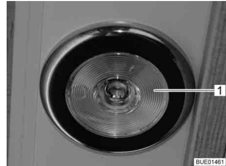
Bild 60 Einbauleuchte, Lichtschalter in der Leuchte
