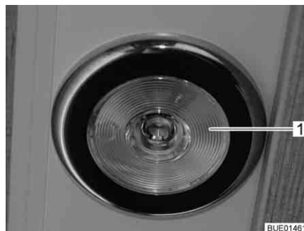
Fig. 60 Lâmpada encastrada, interruptor da luz encontra-se na luz
