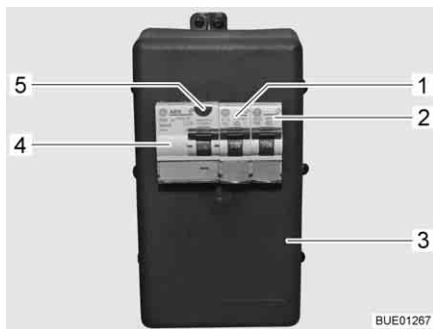
Fig. 189 Caixa de fusíveis de 230 V com disjuntor automático e disjuntor DR
