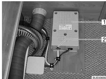
Bild 152 Trafo für elektrische Fußbodenerwärmung
