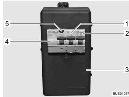
Bild 123 230-V-Sicherungskasten mit Leitungsschutzschalter und FI-Schalter
