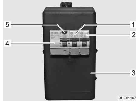
Kuva 136 230 V:n sulakerasia ja johdinsuojakytkin
