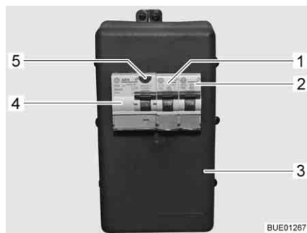
Kuva 146 230 V:n sulakerasia ja johdinsuojakytkin sekä FI-kytkin
