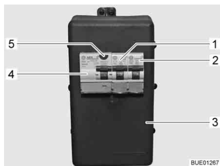
Fig. 167 Caja de fusibles de 230 V con interruptor de protección de línea e interruptor FI
