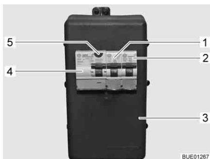
Billede 167 230 V-sikringskabinet med sikkerhedsafbryder og HFI-afbrydere
