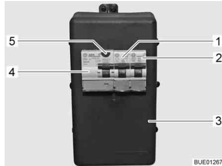
Bild 121 230 V-säkringslåda med ledningsskyddsbrytare och FI-brytare
