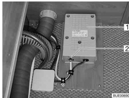
Fig. 141 Trasformatore per riscaldamento elettrico del pavimento
