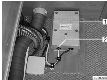
Kuva 141 Sähköisen lattialämmityksen muuntaja
