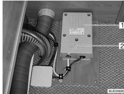
Afb. 173 Transformator voor de elektrische vloerverwarming
