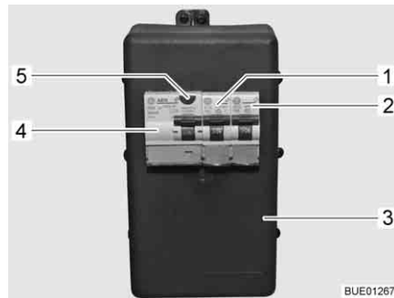
Afb. 152 230-V-zekeringenkast met beveiligingsautomaat en FI-schakelaar
