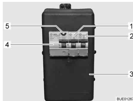
Bild 167 230 V-säkringslåda med ledningsskyddsbrytare och FI-brytare
