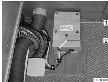
Fig. 186 Trasformatore per riscaldamento elettrico del pavimento
