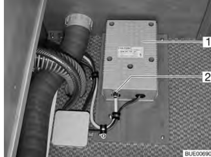
Kuva 137 Sähköisen lattialämmityksen muuntaja
