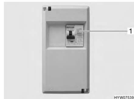
Kuva 117 230 V:n sulakerasia sekä johdin- ja vikavirtasuojakatkaisin (FI)
