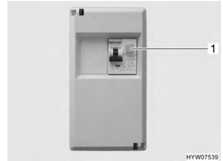
Bild 117 230 V-säkringslåda med lednings- och jordfelsbrytare (FI)
