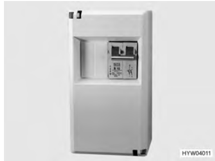
Bild 116 230 V-säkringslåda med ledningsskyddsbrytare
