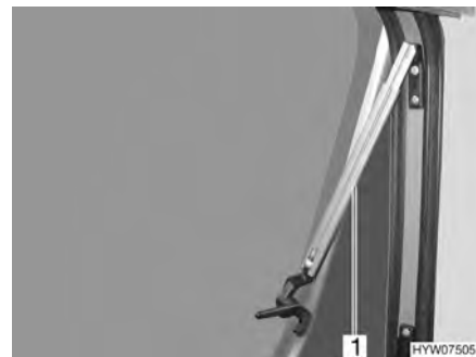
Bild 58 Överkantshängt fönster med automatik-spärrar, öppet
