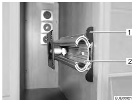
Fig. 61 Support dans le meuble de télévision
