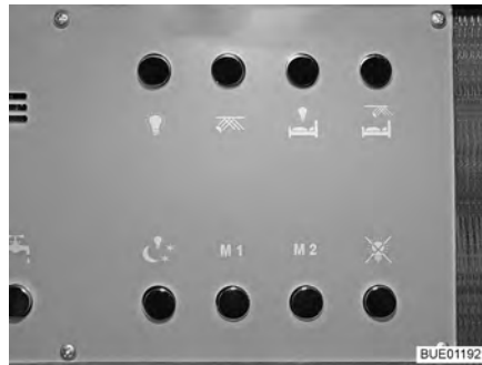
Fig. 56 Panneau de contrôle
