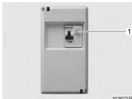
Bild 123 230 V-säkringslåda med lednings- och jordfelsbrytare (FI)
