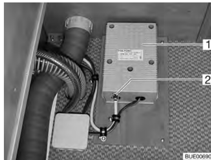
Bild 144 Transformator för elektrisk golvvärme
