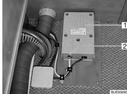
Fig. 166 Transformador para calentamiento eléctrico del piso
